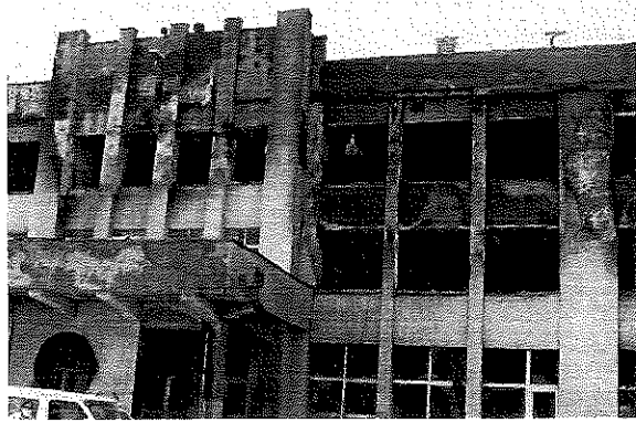
津波火災の怖さを残す石巻市門脇小。二度逃げが可能な裏山があり、避難者は助かった。
