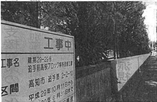
県立高校の対象校は現在すべてで改修工事が進められている
