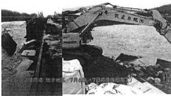
安芸川の決壊現場
